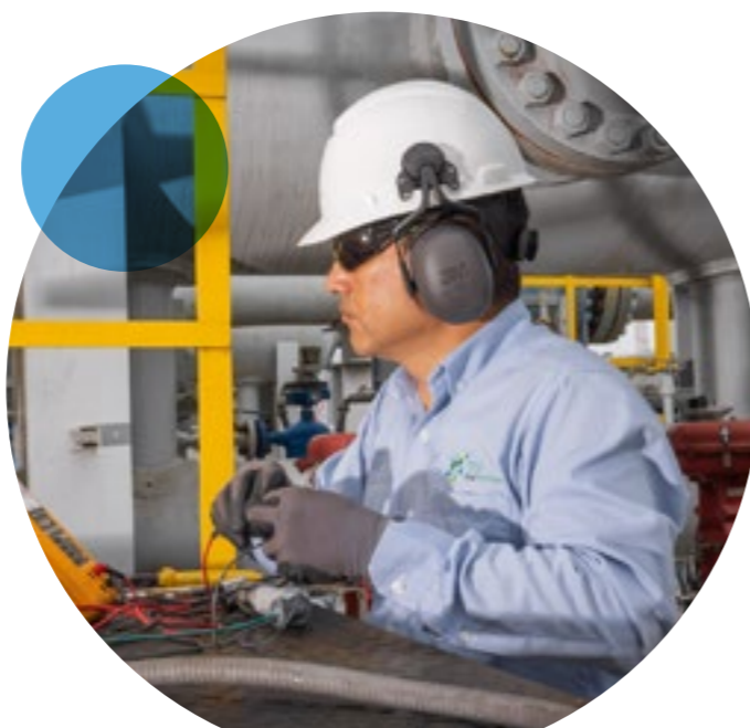
Equipo Estación de Compresión de Gas Padua
