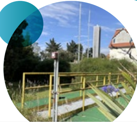
Estación de compresión de gas La Sábana
