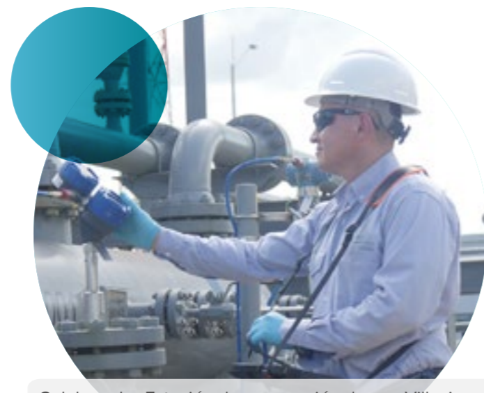
Colaborador Estación de compresión de gas Villavicencio
